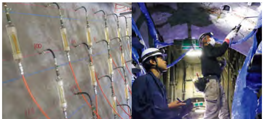
コンクリート構造物メンテナンス（左:リハビリ工法／右:STTG工法）
