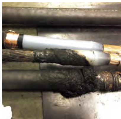
事故ケーブル
