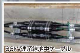
66/22kV受変電設備
